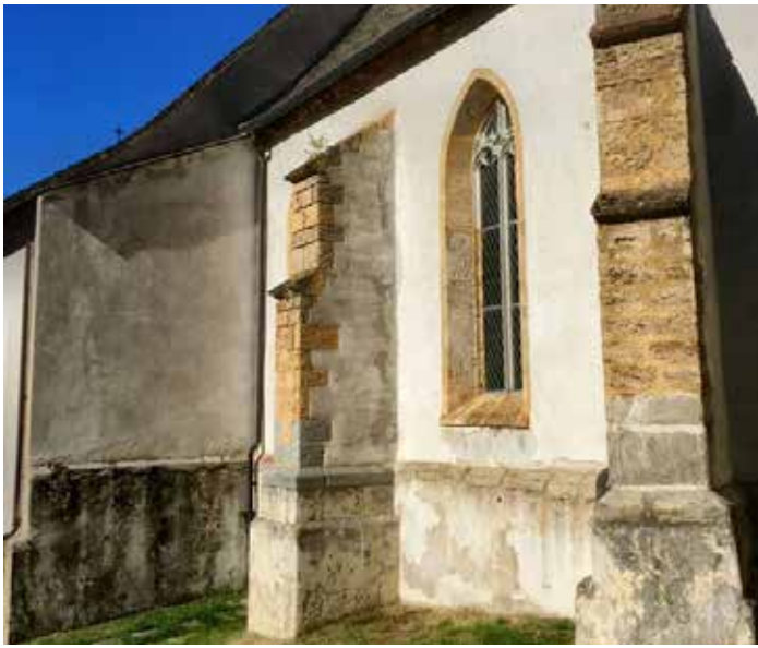
Blick auf die Kirche von Ernen mit Schäden im Mauerwerk. (Foto: zVg)
