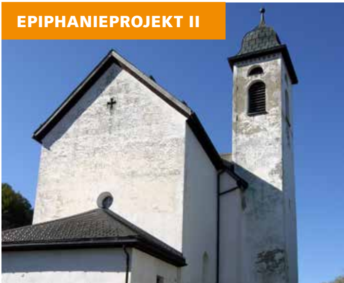
Das beschädigte Äussere der St.-Georgs-Kirche Surcuolm. (Foto: zVg)
