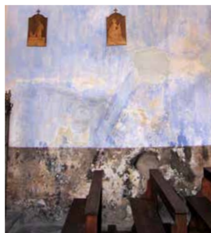
Zwar konnte der Chor vor einiger Zeit renoviert werden. Doch das Kirchenschiff ist in desolatem Zustand. Die Wände samt Verputz bröckeln ab. (Fotos: Luca Invernizzi)
