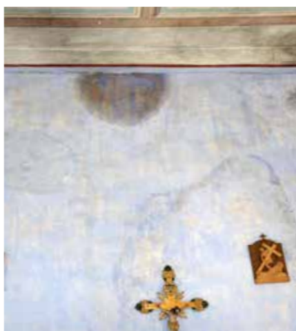
Schimmel und dunkle Verfärbungen breiten sich an den Wänden aus. Der Geruch ist unangenehm. Die Sporen der Schimmelpilze sind allenfalls sogar giftig.
