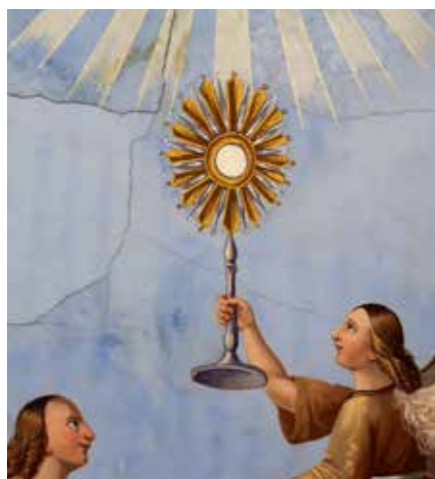
Die Decke weist Risse auf. Sie bedrohen zwar vorderhand nur die antiken Gemälde. Doch geschieht nicht bald etwas, droht der Kirche Einsturzgefahr!
