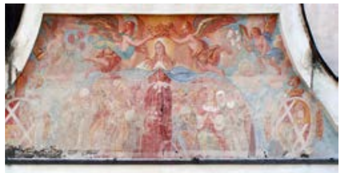
Ein Blick auf das beschädigte Schutzmantelmadonna-Fresko an der Südfassade der Kirche vor der Restaurierung. (Fotos Doppelseite: zVg)
