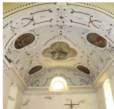
Unübersehbare Schäden im Innern der Kirche.
