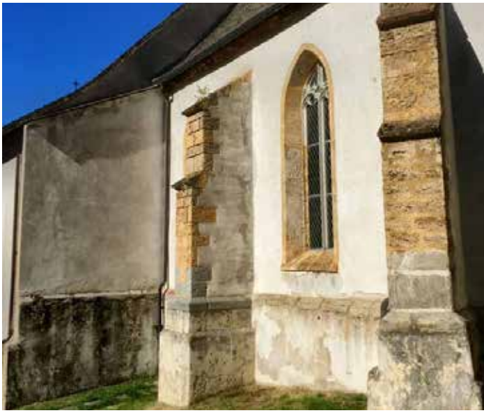
Vue sur l'église d'Ernen avec des dommages.
