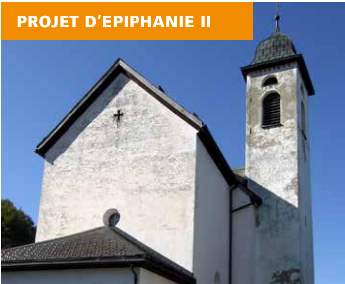
L'extérieur endommagé de l'église à Surcuolm.
