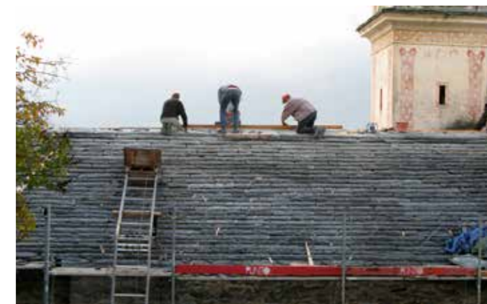
Tuile pour tuile a été remplacée. Le toit est à nouveau imperméable.
