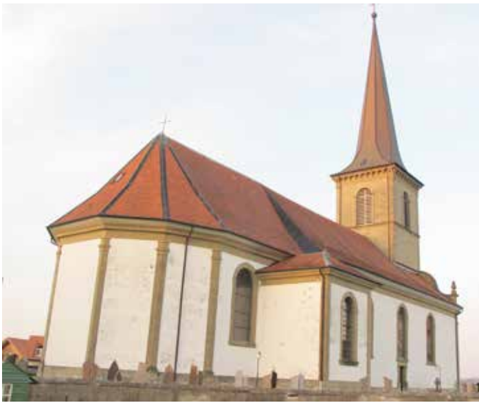
L'église paroissiale du Glèbe: le toit présente des fuites et menace la salle. (Photo: L. Nissille)
