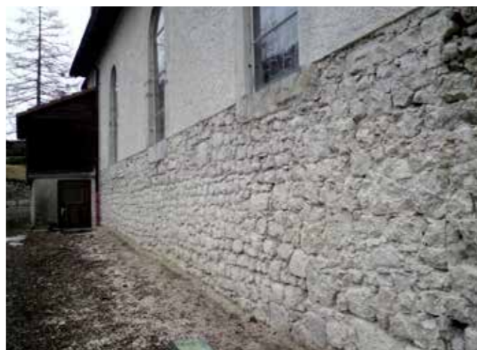
Les parois commencent à s'effriter.
