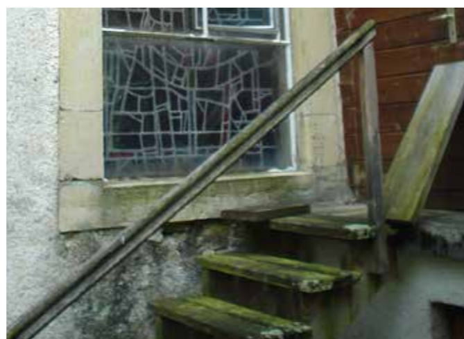
La moisissure se répandait à l'intérieur et à l'extérieur.
