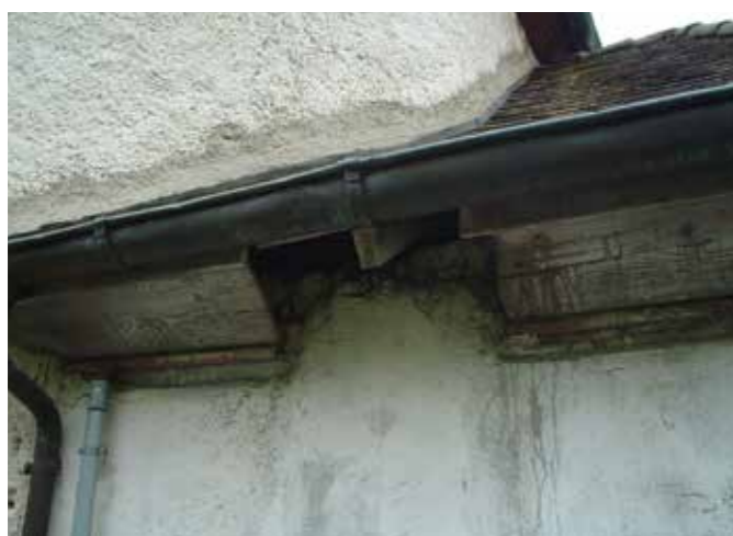
La toiture perméable favorisait l'intrusion d'humidité.
