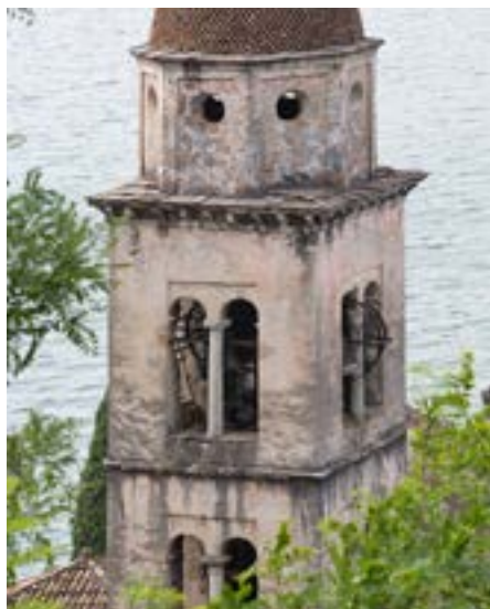
Le clocher de l'église médiévale tardive endommagé.
