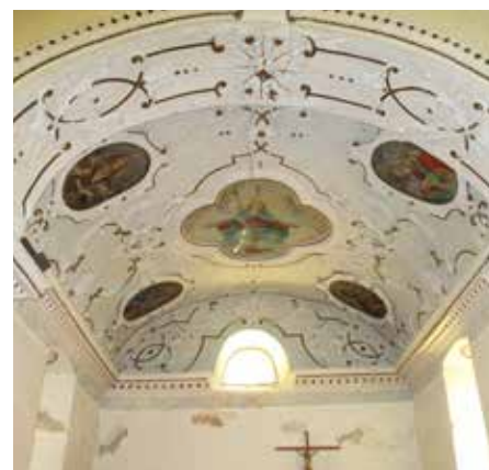
L'intérieur souffre de dommages considérables.
