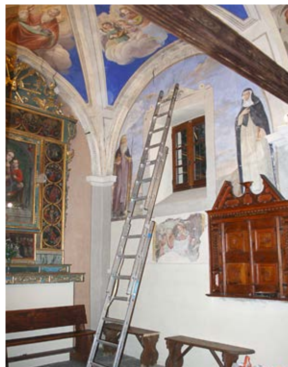
L'autel de la Vierge avec des fresques endommagées.
