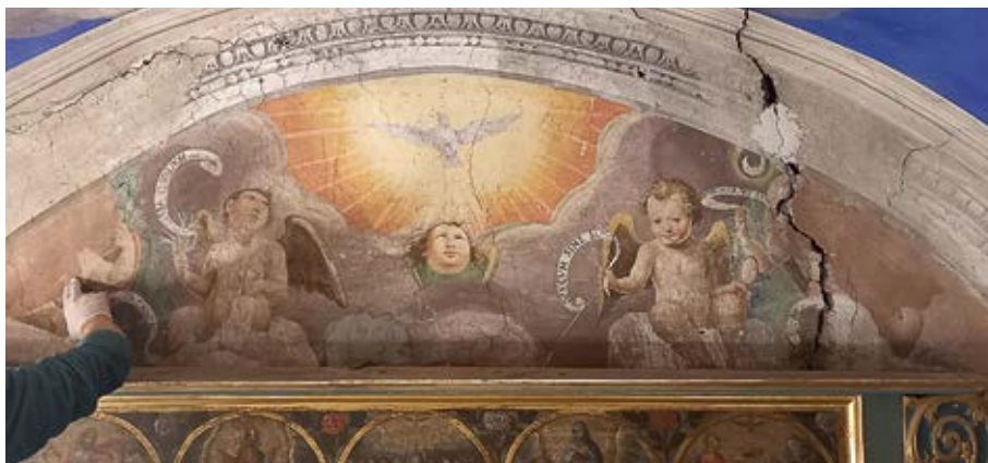
Voûte de chœur endommagée au-dessus de l'autel de la Vierge avec la colombe du Saint-Esprit et des anges.
